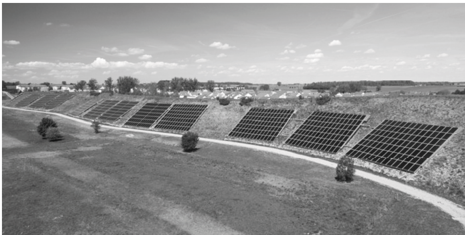
Abbildung 5-22: Solar Kollektoren auf dem Lärmschutzwand in Crailsheim Hirtenwiesen 50
